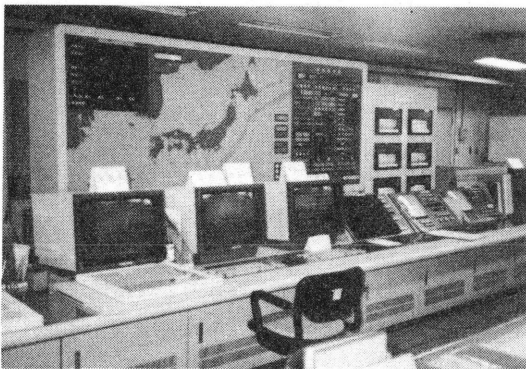
写真 大型表示パネル
