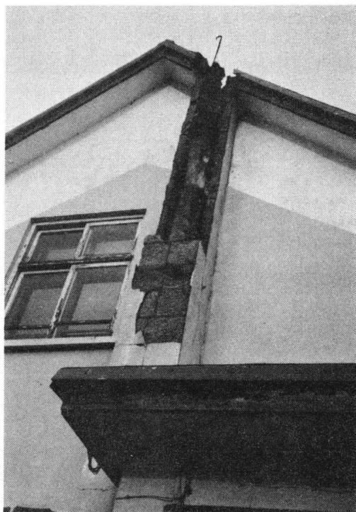
写真3 留萌市東幌の民家のブロック造り集合煙突崩壊（留萌測候所撮影）
