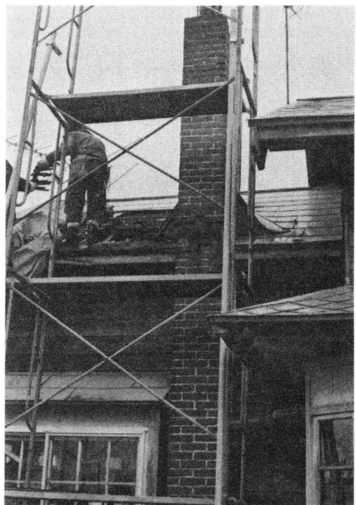
写真2 沼田町第4民家のレンガ造り集合煙突が折損し、トタン屋根を突き破る（沼田町提供）
