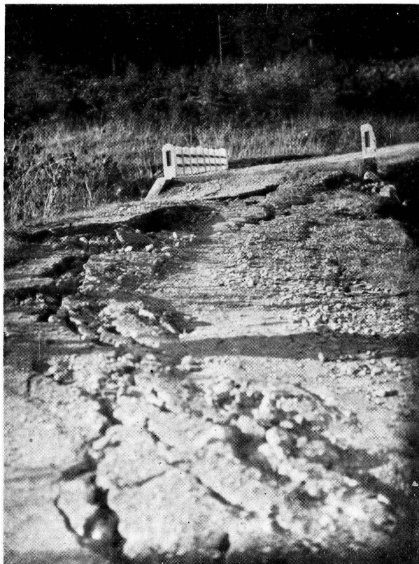
層斷る走に西東・道縣る至に湯の姫りよ保原 圖二十八第 方上・裡○六橋の築新し裂龜路道てひ沿に線 りよ方東・す示をるせ下沈近附てり残に
