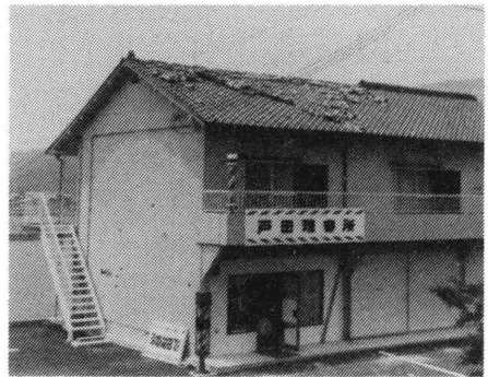
写真2 かわらの落ちた民家（神崎郡神崎町東柏尾、5月30日11時）
