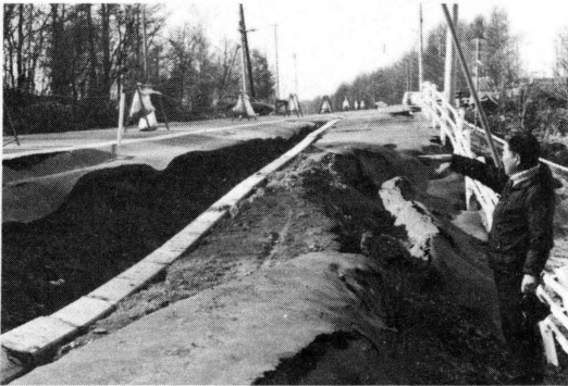
写真 6.3.3 静内町西川・田原(道々 846号線)の道路の被害
