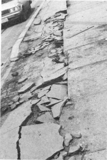
写真6.3.26 浦河町東町道路の破損と沈下
