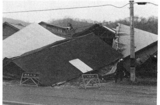
写真 6.3.18 浦河町界町のチップ工場の全壊
