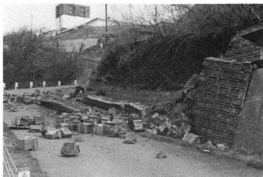
写真 6.3.31 浦河測候所道路石垣の倒壊
