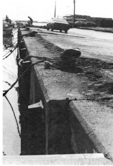
写真6.3.28 浦河港岸壁上部工のせり出し(割目は土盛りで応急修理されている)
