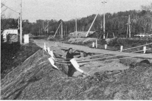
写真 6.3.13 三石町緑丘・旭町線の道路の被害
