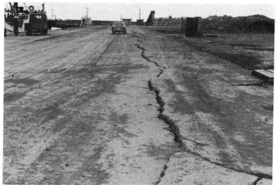
写真6.3.29 浦河港岸壁エプロン部の亀裂
