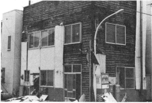
写真 6.3.19 浦河町大通りの家屋の被害
