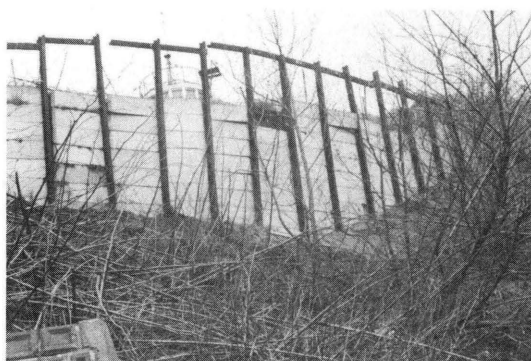
写真 6.3.33 浦河測候所下の急斜面の土止め柵の破損
