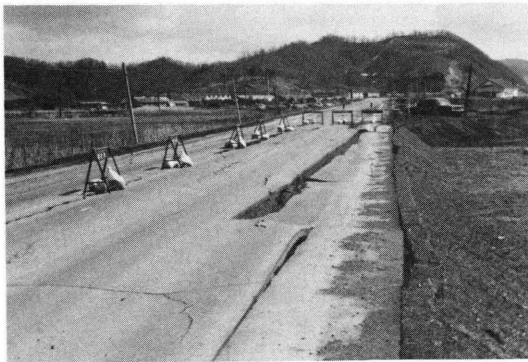
写真 6.5.8 静内町浜浦和付近道路の路肩沈下
