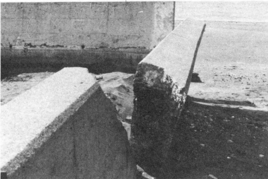
写真 6.3.15 三石町西浦里の砂防堤よう壁の被害（厚さ40cmのよう壁が鉄筋と共に切断され傾斜した）
