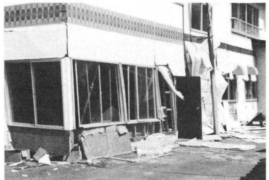
写真 6.3.11 三石町越海町のドライブイン建物被害
