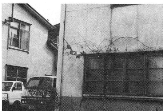
写真 6.3.36 様似町住家のモルタル外壁の亀裂
