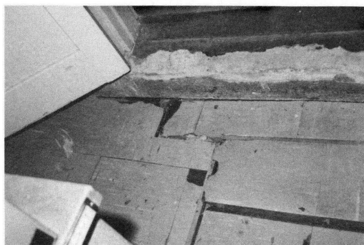
写真 6.3.34 浦河測候所庁舎2F床面の亀裂
