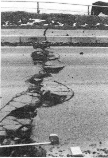
写真 6.3.2 新冠町高井の泥火山帯付近道路の地割れ
