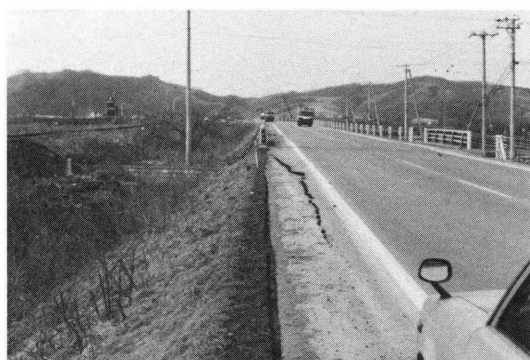
写真 6.3.35 浦河町幌別付近道路の亀裂
