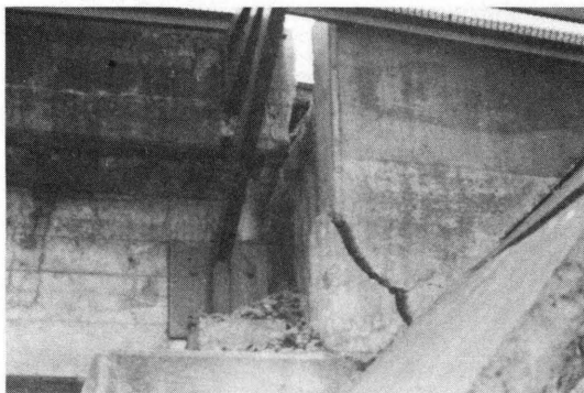
写真 6.3.21 浦河町東町入口付近の国鉄陸橋の被害
