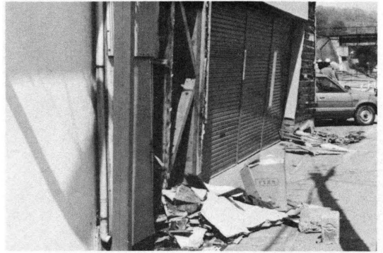
写真 6.3.22 浦河町常盤町の家屋の被害
