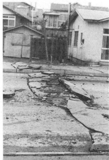
写真 6.3.24 浦河町東町道路の亀裂
