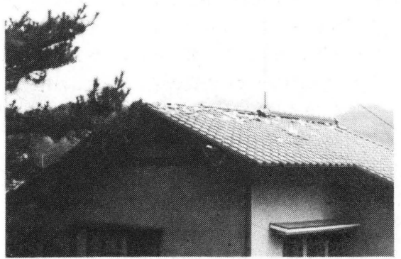
Photo. 3. 川奈字水無田の棟瓦落下状況の一例
