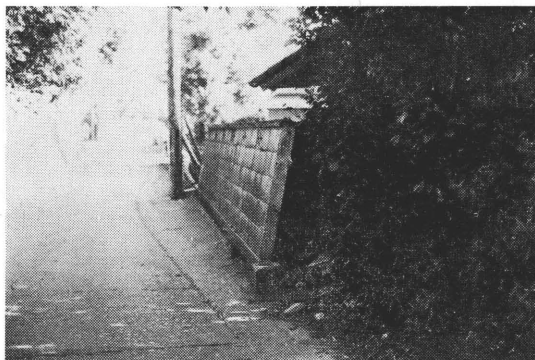
Photo. 1. 東伊豆町入谷のコンクリートブロック塀の傾斜
