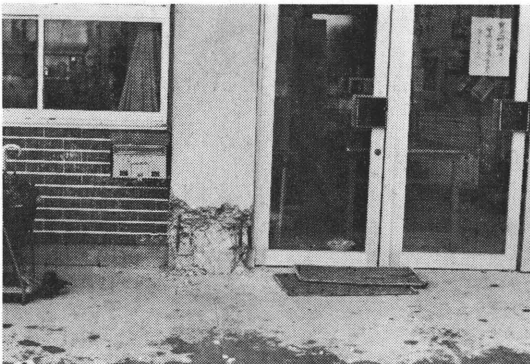
Photo. 3. 石越町長根, 石越町公民館, 玄関側柱の破損状況
