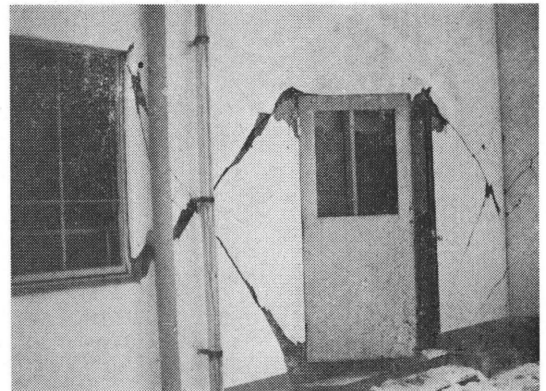
Photo. 6. 南方町, 西郷小学校, き裂の入った廊下のコンクリート壁
