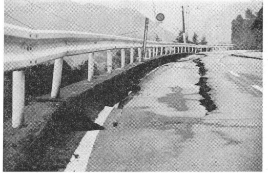
Photo. 4. 路肩の陥没とひび割れ（河津町川横）
