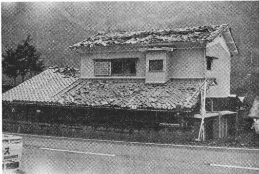
Photo. 8. 屋根瓦の落下（河津町下佐ヶ野）
