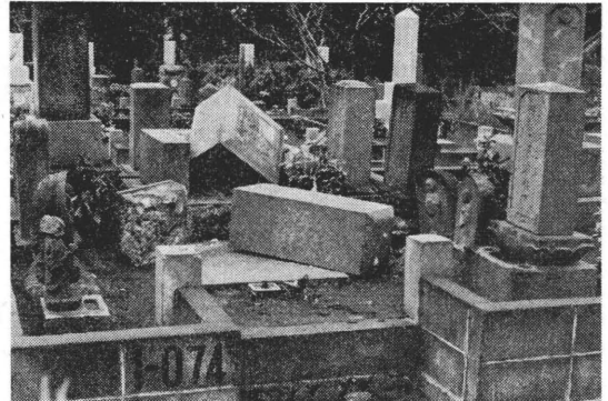
Photo. 12. 墓石の転倒（大島元町墓地）
