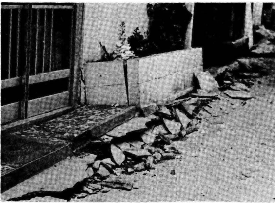
Photo. 45. 湯布院町湯平地区 Photo. 44 に同じ 1975年4月21日 (大分地方気象台撮影)
