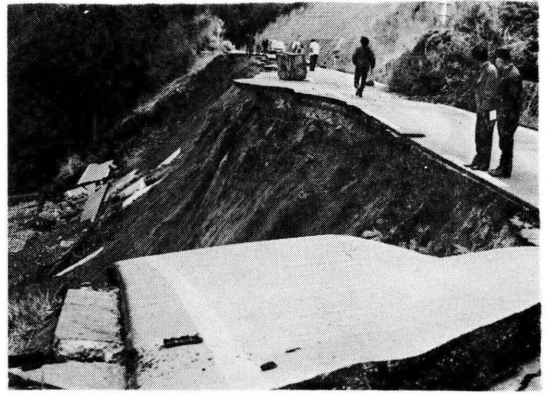
Photo. 11. 湯布院町 九州横断道路の決壊 1975年4月21日 (大分地方気象台撮影)
