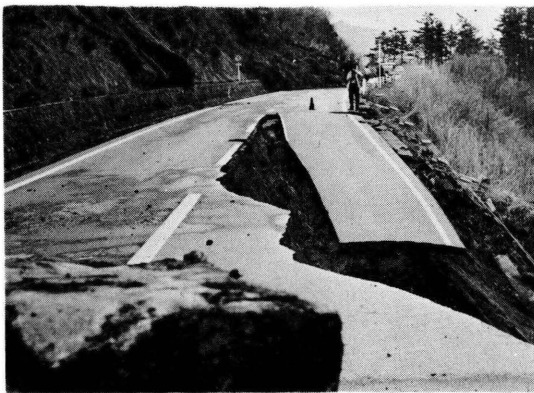
Photo. 9. 湯布院町 九州横断道路の決壊 (長さ100m, 高さ50m) 1975年4月21日 (大分地方気象台撮影)
