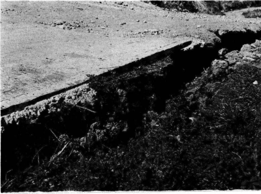
Photo. 19. 庄内町内山地区 部落入口の道路路肩のくずれ 1975年4月24日 (福岡管区気象台撮影)
