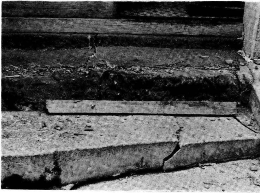
Photo. 44. 湯布院町湯平地区 玄関前のひび割れ (基礎部分が前方に20~30cm 押し出されている) 1975年4月21日 (大分地方気象台撮影)
