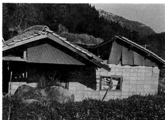
Photo. 16. 庄内町内山地区 倉庫の屋根が北西へ移動 1975年4月24日(福岡管区気象台撮影)
