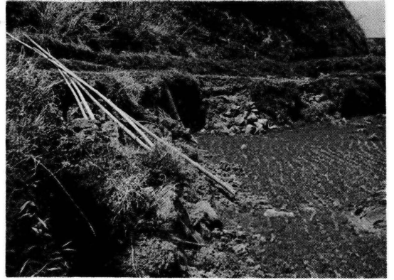
Photo. 40. 湯布院町扇山地区 水田の土手崩れ
