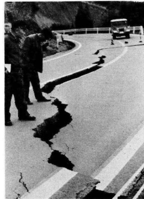
Photo. 12. 湯布院町 九州横断道路の決壊 1975年4月21日 (大分地方気象台撮影)
