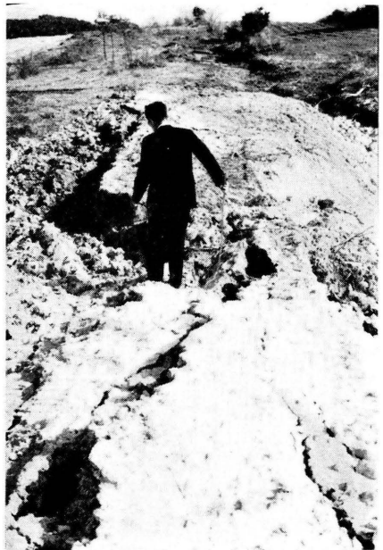
深沢の築堤のき裂
