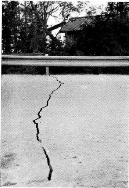
築館町国道のき裂（東西方向）
