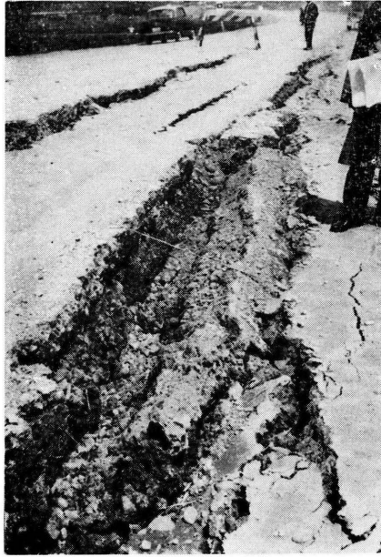
国道4号線古川市，高清水町境界付近のき裂 (昭和37年3月完成したもの)
