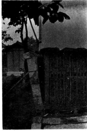
Photo. 5. 白石市寺岡の土蔵の一部崩壊
