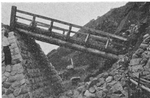
Fig. 3a. 新田橋の脚台の破壊状況
