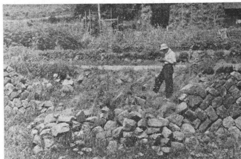
Fig. 5. 本郷における石垣側面の破壊状況
