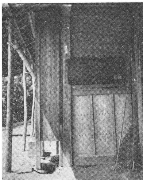
写真 2. 柱・壁・腰板のゆるみ (岡本氏宅)
