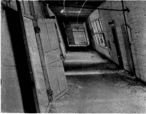
第32図 浦河日赤病院 (その2) ゆがんだ内部 傾斜 14°
