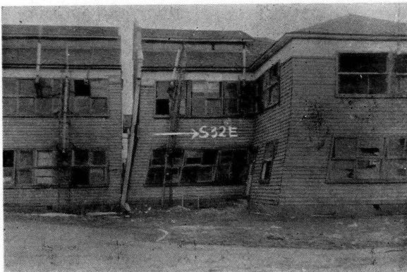
第30図 浦河日赤病院 (その1) 病棟半倒壊
