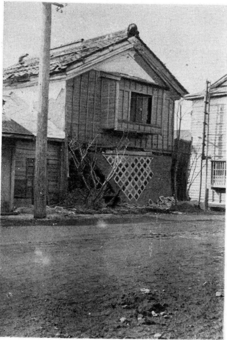
第40図 壁の脱落 (様似旧市街)
