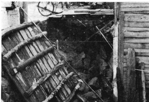
(8) 延岡市, 石垣崩壊
