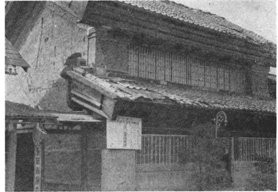
第4圖 福島縣浪江町、土藏造の家屋の破損
