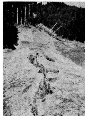
（寫眞 24）脇本村梅澤に於ける貯水池堤防の龜裂，向ふに山崩れが見えて右手に水が溢えられてゐる
