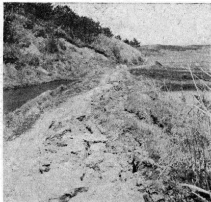
（寫眞 20）五里合村安田附近の道の破壊，此の道は特に盛上で柔かい所であつた
