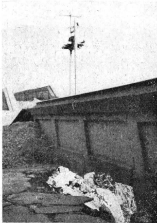
第6圖 鹽屋崎燈臺の崖崩れと煉瓦塀の破損
