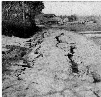
（寫眞 22）五里合村箱井に於ける道路の龜裂，相當固い地盤であつた
