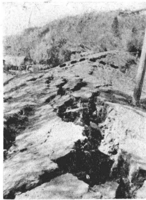
(寫眞 25) 脇本村浦田の貯水池 堤防の龜裂, 缺潰, 點線は缺潰場所
