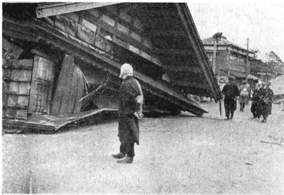
(寫眞 6) 船川港町羽立附近の倒潰家屋, 一階が潰れて街道に乗出した
