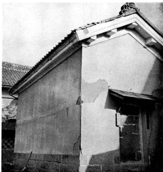
(3) 須賀川町農業倉庫の破損 (南西方より撮影)
