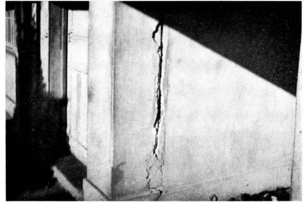
同校教室煉瓦壁とコンクリートの柱との間の龜裂
