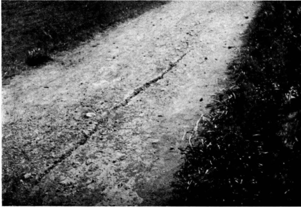
御坊驛東方の道路の龜裂
