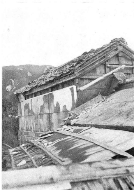
新島本村，土藏の抗火石の壁の剝落
