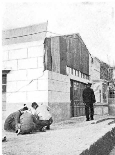
式根島，抗火石の外壁の剝落
