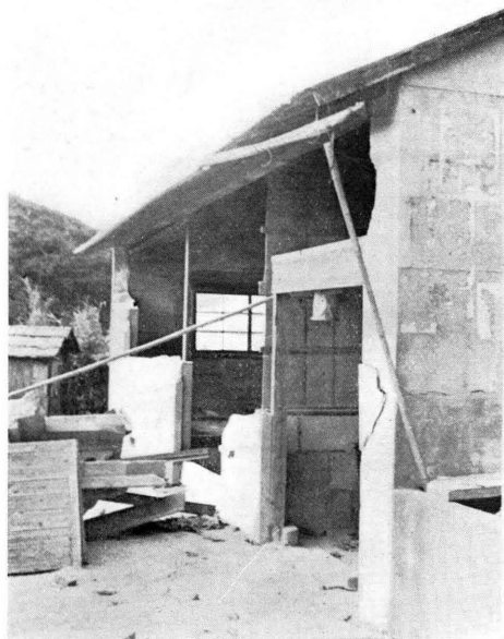
式根島，消防器具置場の大破
