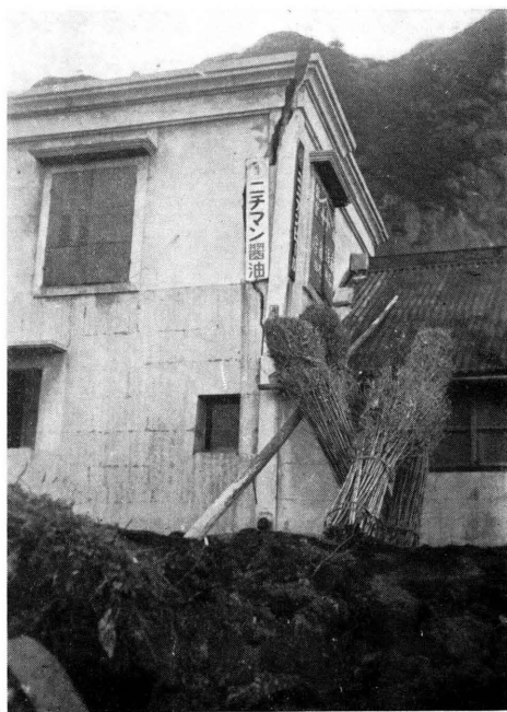
新島本村，土藏の抗火石の壁の龜裂
