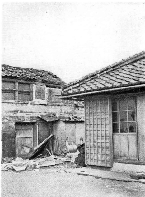
式根島，土藏の破損
