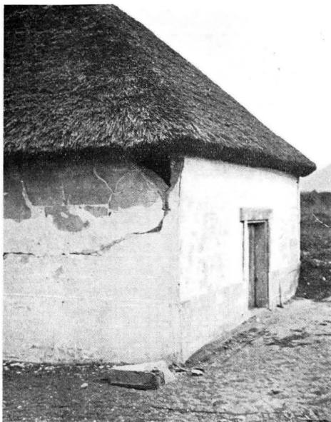
新島本村，抗火石で作つた納屋の壁の破損
