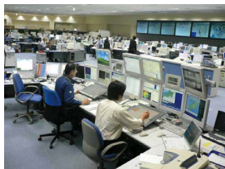
ATMC 運用室内の作業風景
