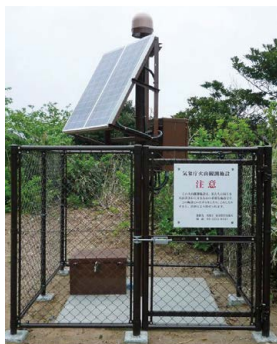
GNSS 観測装置
