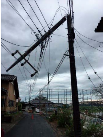
電柱の倒壊による配電設備の故障（千葉県多古町提供）
