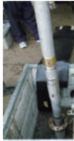
傾斜計 (観測孔に埋設)
