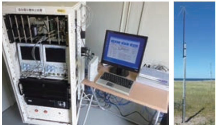
(左写真) 雷放電位置検出装置 (右写真) アンテナ
