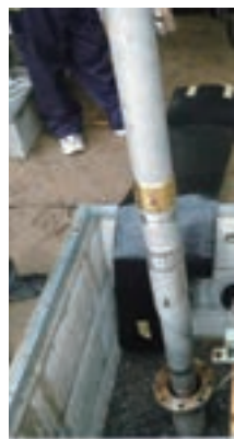
傾斜計 (観測孔に埋設)
