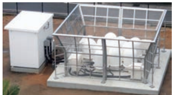
観測局(高松)の全景。フェンス内に11個のアンテナが設置されています。
