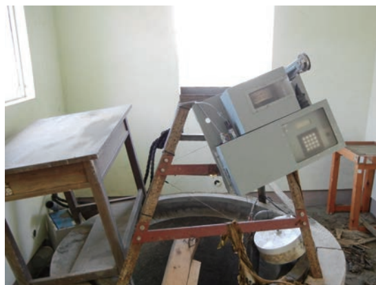
施設が損傷した鮎川検潮所の内部
