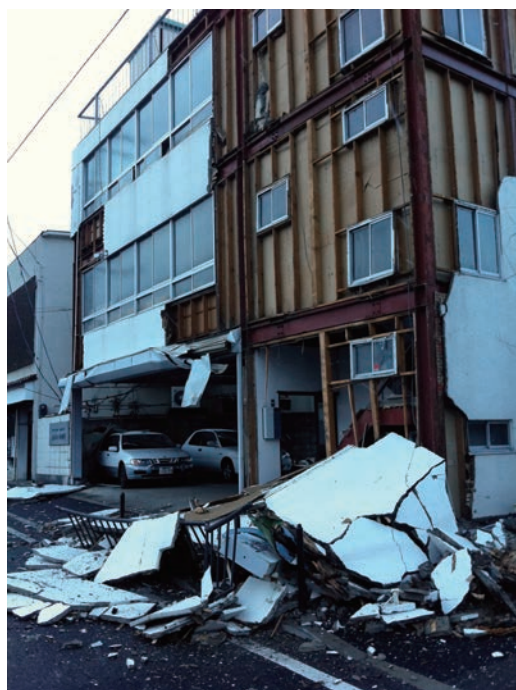
ビル外壁の落下・破損（福島県福島市）
