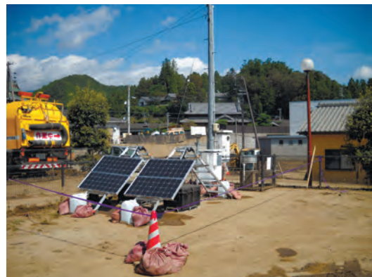
写真 2.2.3.2 本宮地域雨量観測所に仮設置した可搬型観測装置
