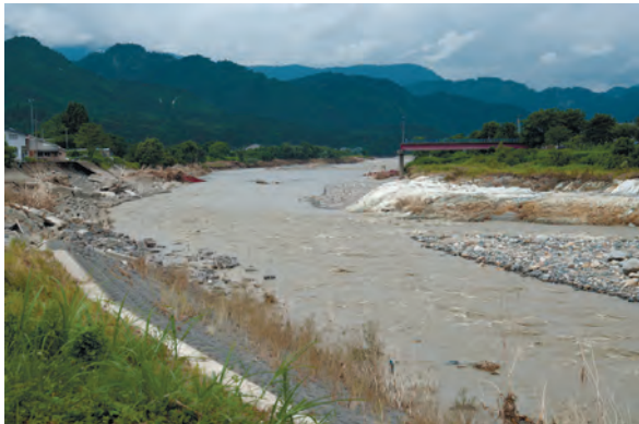
写真2.1.3.6 只見町 伊南川 小川橋落橋 8月2日撮影
