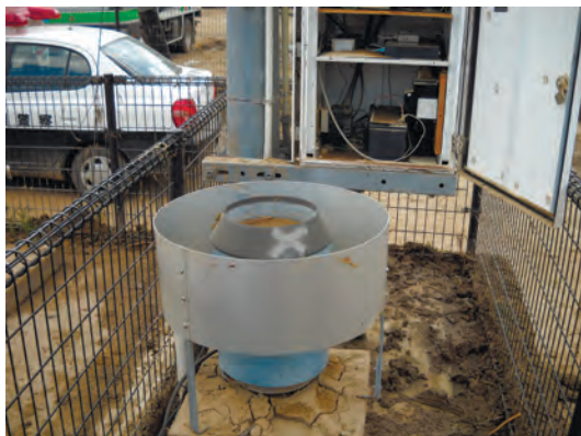
写真 2.2.3.1 水没し機能を失った本宮地域雨量観測所
