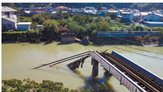
写真 2.2.3.3 那智勝浦町の JR 紀勢線の橋梁流出（和歌山県提供）
