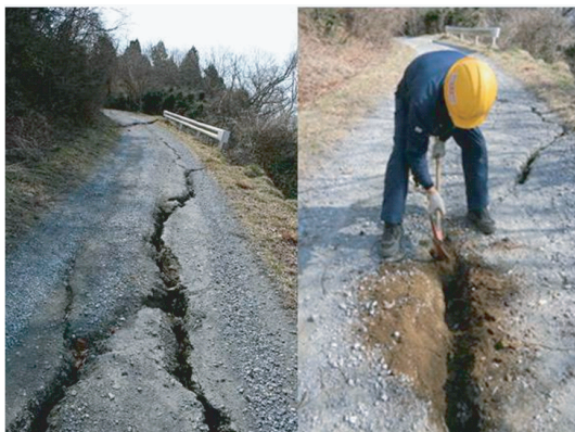
第5.10.9図 宿舎～大気環境観測所間の通勤路における地割れ及び職員による補修作業の様子
