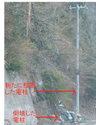
第5.10.10図 大気環境観測所への送電経路の電柱 津波により倒壊したが，約40日後新たに設置された。
