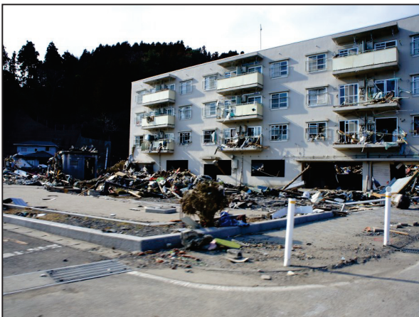
写真 259 石巻市鮎川浜① 3階部分まで浸水した建物
