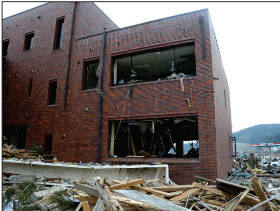
写真 236 大船渡市三陸町起喜来① 津波により内部を破壊された公民館
