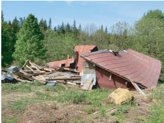
写真138 農作業小屋の倒壊(第3.3.18図-④)
