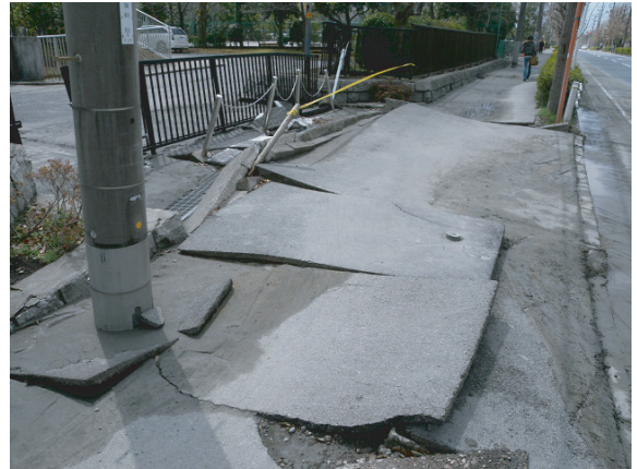
写真109 富岡 歩道の破損
