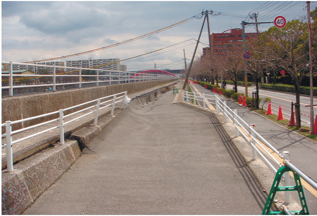
写真108 富岡 川沿いの歩道の歪み
