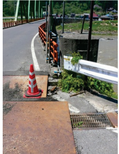
写真119 百合居橋梁継ぎ目の破損 (第3.3.14図-①)
