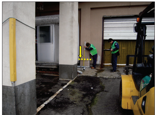
写真 68 津波の痕跡 (第 3.2.59 図の 68)
