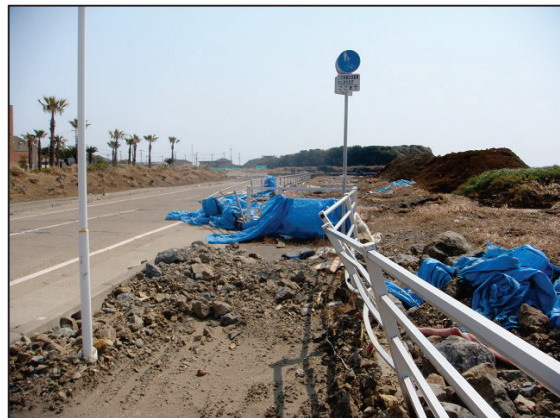
写真 280 銚子市② 千葉科学大学前のガードレールの破損
