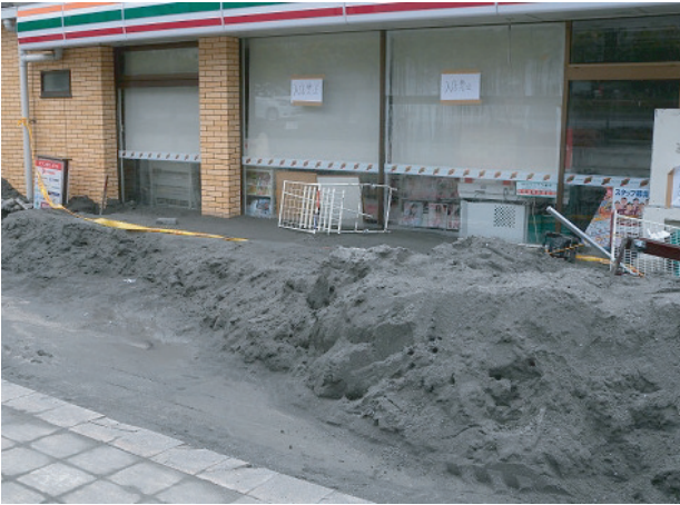
写真 112 明海② コンビニ建物の沈下・液状化による噴砂
