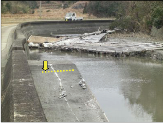
写真190 津波の痕跡 (第3.2.132図の193)
