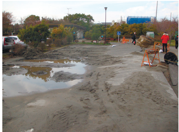
写真 115 高洲中央公園 液状化による噴砂
