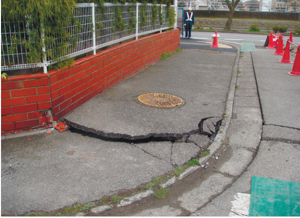
写真106 美浜 歩道上の亀裂、浮き上がり
