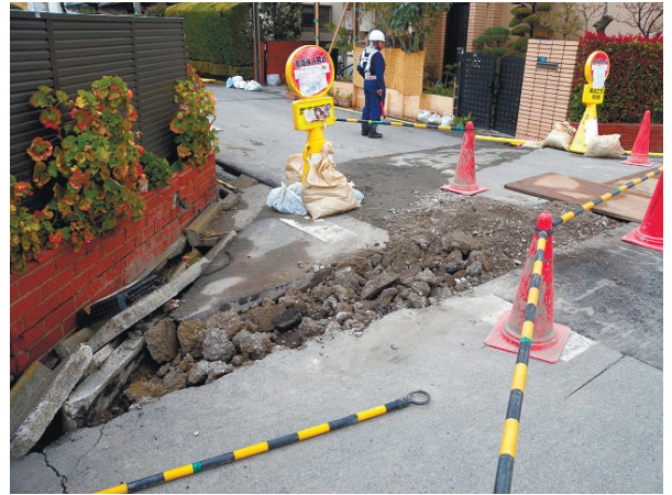
写真107 美浜 地盤の浮き上がりによる水道管の損傷
