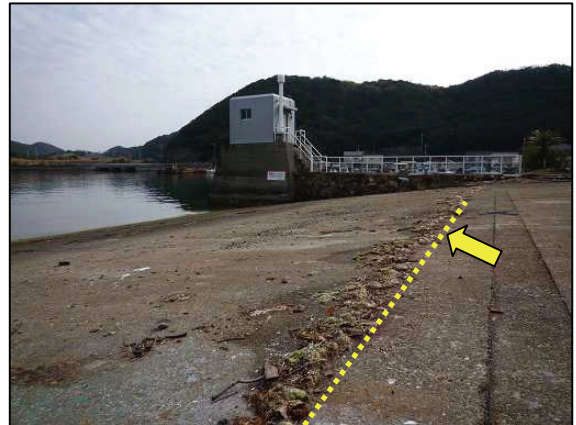
写真202 津波の痕跡（第3.2.137図の205） 津波による漂着物を確認
