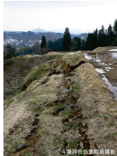
写真 143 水田畦部分の亀裂 (左写真破線内) (第 3. 3. 20 図-③)
