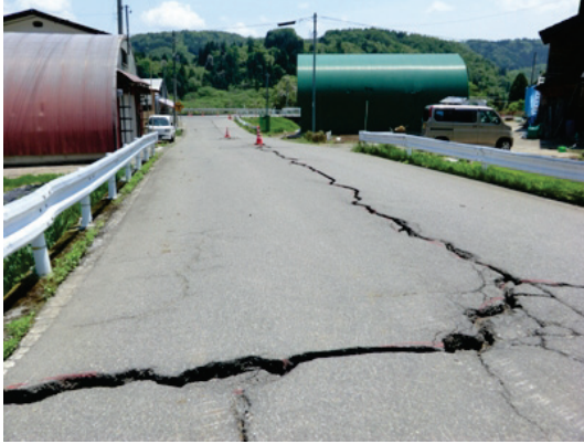
写真123 道路の地割れ (第3.3.15図-①)
