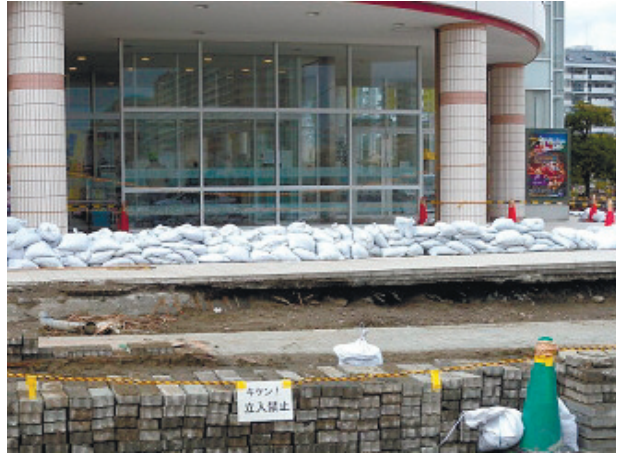
写真 113 明海② スーパー周囲の地盤が沈下
