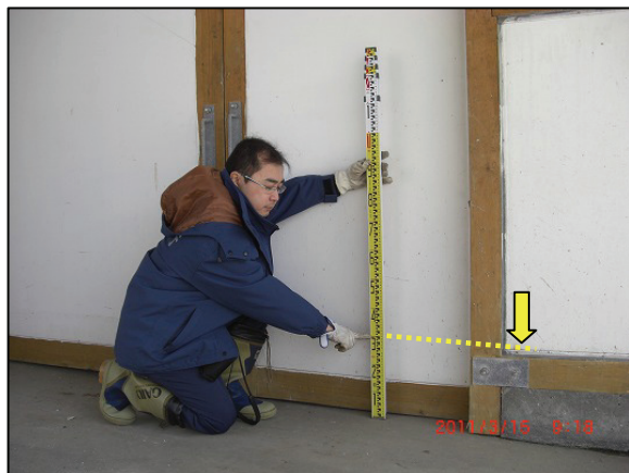
写真49 津波の痕跡 (第3.2.46図の49)
