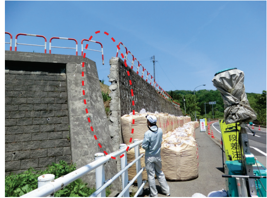
写真130 国道117号沿いの擁壁の剥離(破線内)(第3.3.15図-⑧)
