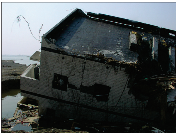
写真 249 陸前高田市② 津波により倒壊したコンクリート建造物
