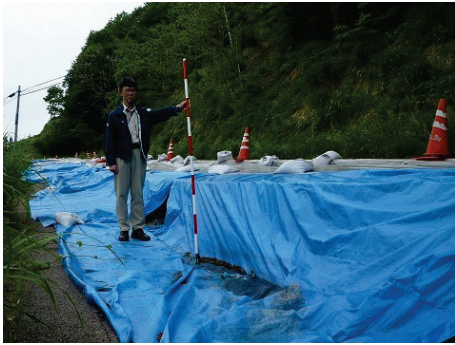
写真144 県道49号の道路陥没(第3.3.21図-①)
