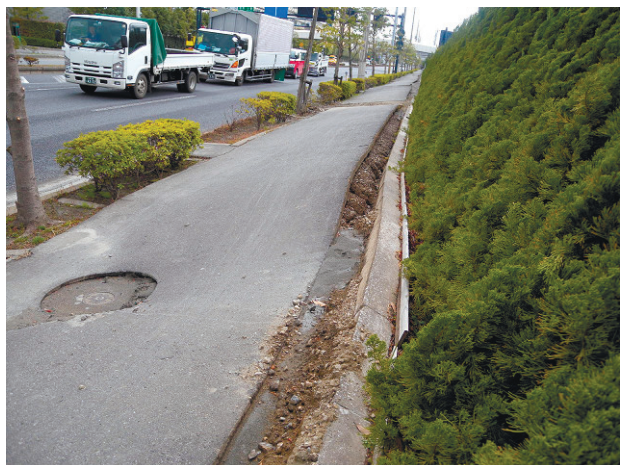
写真 117 舞浜（浦安市総合運動公園前） 浦安市総合運動公園前の歩道の歪み
