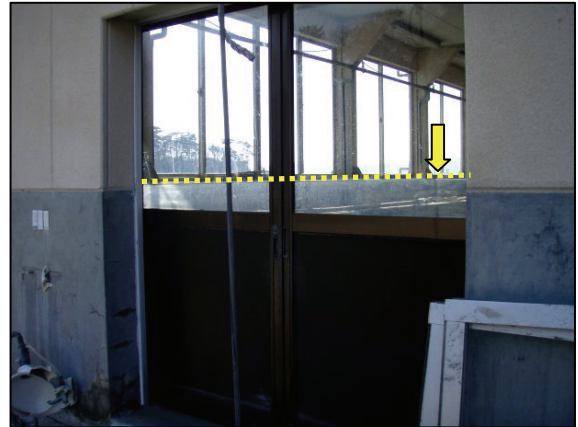
写真130 津波の痕跡 (第3.2.97図の130)
