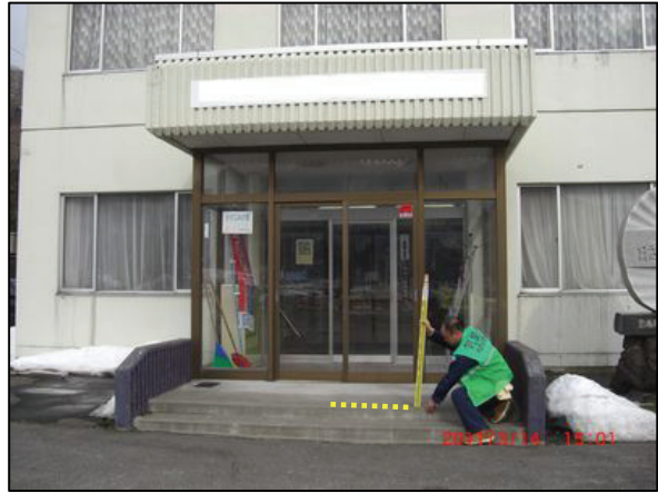
写真 62 津波の痕跡 (第 3.2.52 図の 62)
