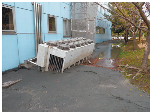
写真111 明海① 噴砂により傾いた空調機
