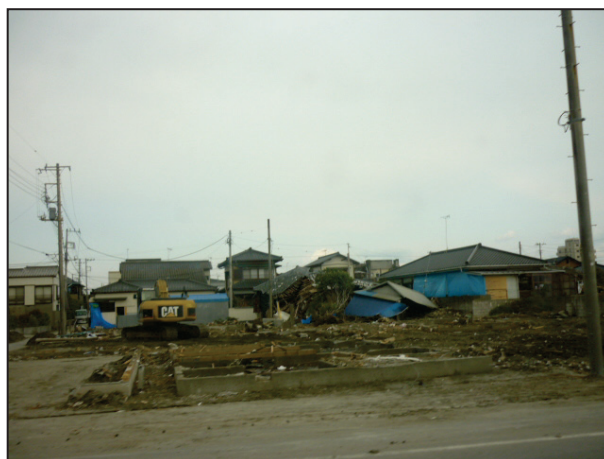
写真 283 旭市③ 下永井地区の被害状況
