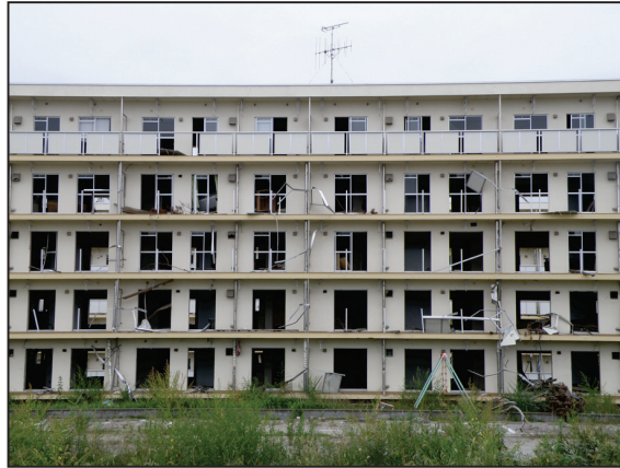
写真 248 陸前高田市① 4階部分まで浸水した住宅
