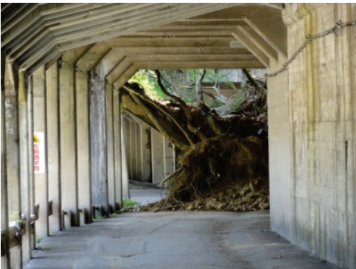
写真122 県道408号スノーシェッド内の土砂崩落(第3.3.14図-④)
