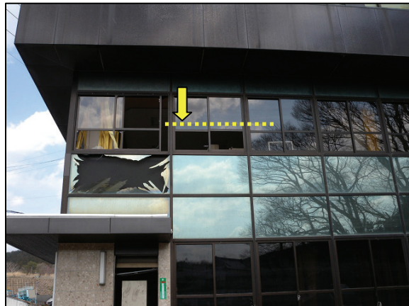
写真111 津波の痕跡 (第3.2.87図の111)
