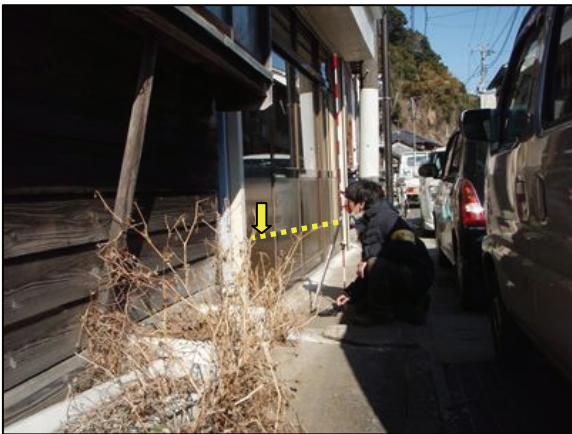
写真 150 津波の痕跡 (第 3.2.110 図の 150)
