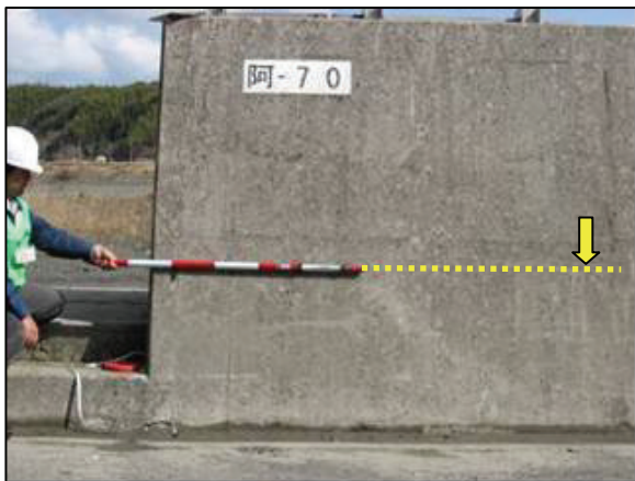
写真 210 津波の痕跡 (第 3.2.142 図の 213)
