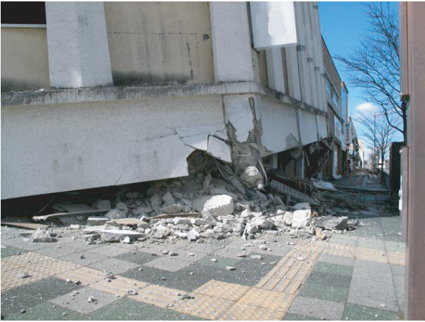
写真 31 須賀川市八幡町：6 強
