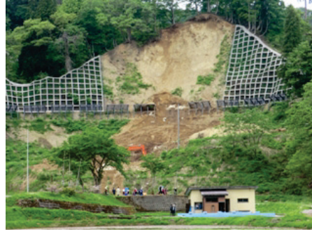
写真 148 浦田小学校裏のがけ崩れ (第 3.3.23 図-①)
