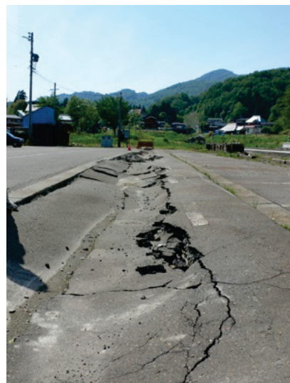
写真132 森宮野原駅駐車場の陥没(第3.3.17図-①)
