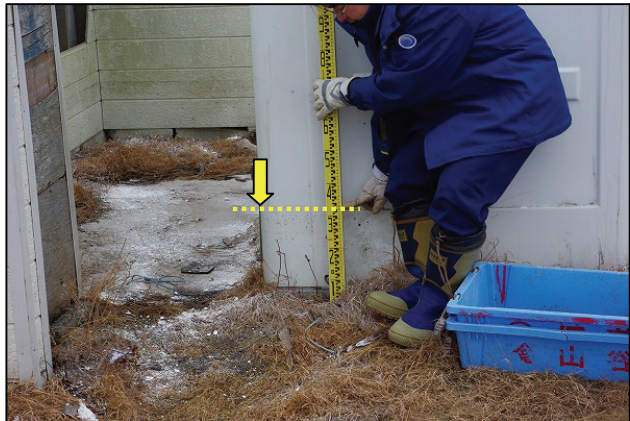
写真39 津波の痕跡（第3.2.42図の39）
