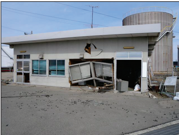
写真 275 いわき市小名浜① 検潮所付近の事務所の被害
