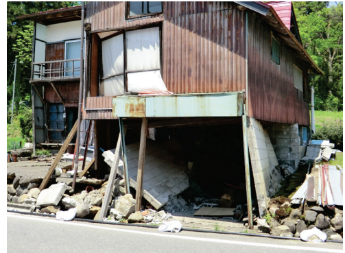
写真121 塀の倒壊と民家の傾斜(第3.3.14図-③)
