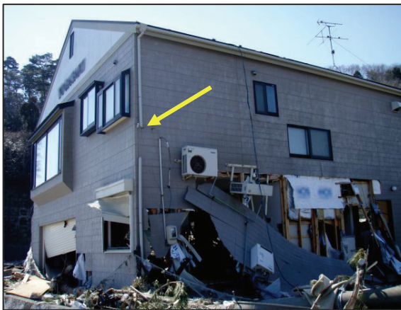
写真135 津波の痕跡 (第3.2.101図の135) 黄色矢印部分の雨樋が津波により破損
