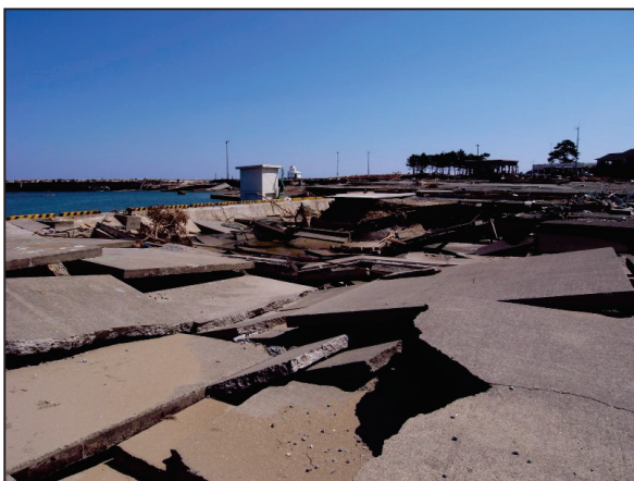
写真 269 相馬市① 検潮所付近の岸壁の損壊
