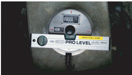
写真3 奥州市胆沢区：【活用停止】 震度計台と地盤との間の隙間、震度計台が傾く、西側（右方向）に傾いた。
