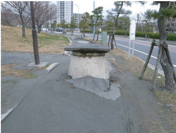
写真110 明海① 浮き上がったマンホール
