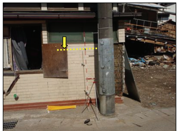
写真148 津波の痕跡 (第3.2.109図の148)
