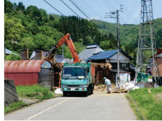
写真128 青倉地区公民館の倒壊 (第3.3.15図-⑥) 上段4月30日撮影, 下段5月25日撮影
