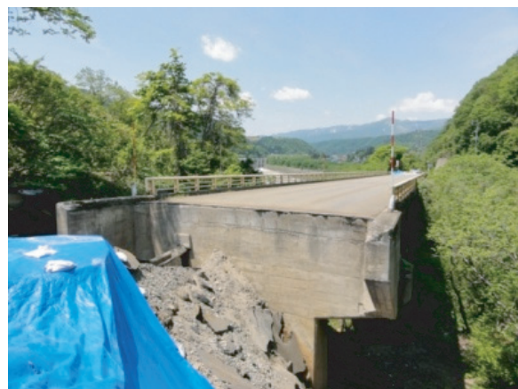
写真118 境川橋梁継ぎ目の落下(第3.3.13図-①)
