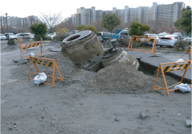
写真 114 高洲中央公園 浮き上がった防火水槽のマンホール
