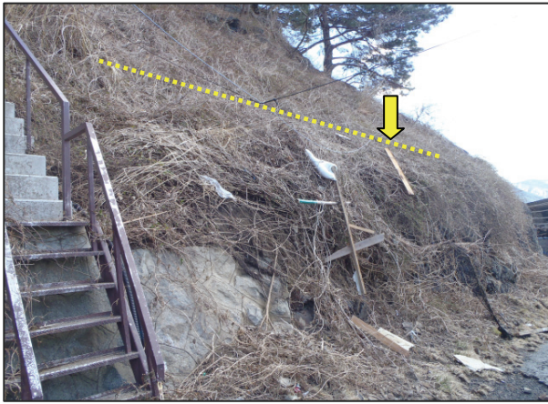
写真100 津波の痕跡（第3.2.83図の100） 漂着物を確認
