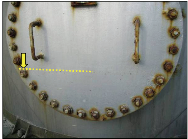
写真31 津波の痕跡 (第3.2.33図の31)
