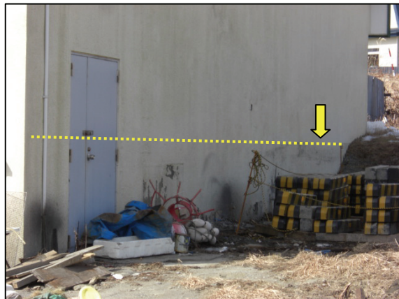
写真13 津波の痕跡 (第3.2.19図の13)
