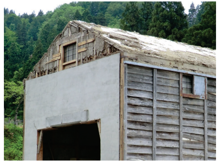
写真 149 倉庫の屋根の破損 (第 3.3.23 図-②)
