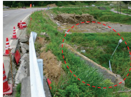
写真147 倒壊した外灯(破線内)(第3.3.22図-②)
