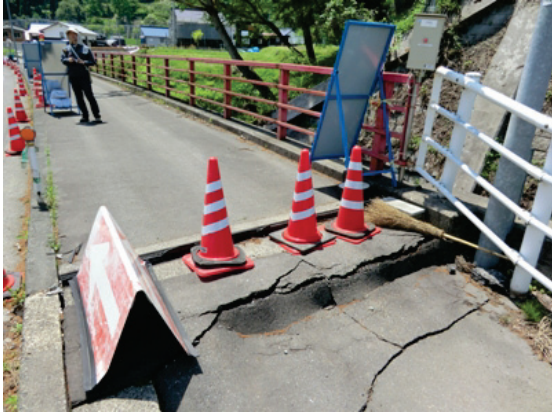
写真129 青倉橋継ぎ目の段差 (第3.3.15図-⑦)
